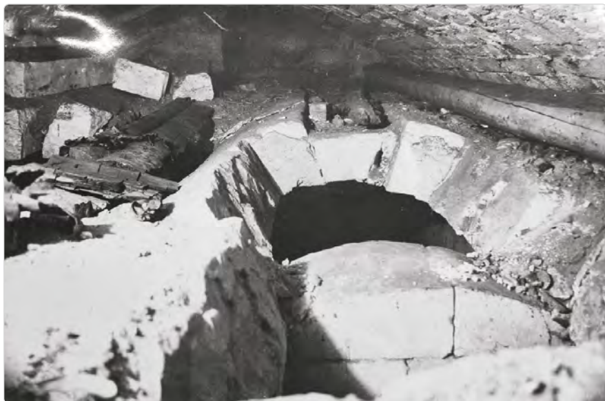
Рис. 20. Разорённые могилы Лопухиных. ЦГА г. Москвы. Ф. 2971. Оп. 1. Д. 42. Л. 16. Подпись под фотографией «Открытие сети калориферных каналов дало возможность проникнуть в подполье (выделено автором) и обнаружить в ц. части памятника наличие 4-х смежных б/к. склепа; они оказались уже раскрытыми и содержимое их приведённым в хаотическое состояние, над б/к. склепами возвышается на 70 см кирпичный луковичный свод пролётом в 4,20 мт; свод сложен на романском цементе в XIX веке; захоронения в склепах относятся ко 2-й половине XVIII века»
